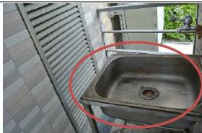
水槽洗淨、排水孔暢通
